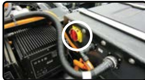
40 & 80kWh (1) HV Isolator
